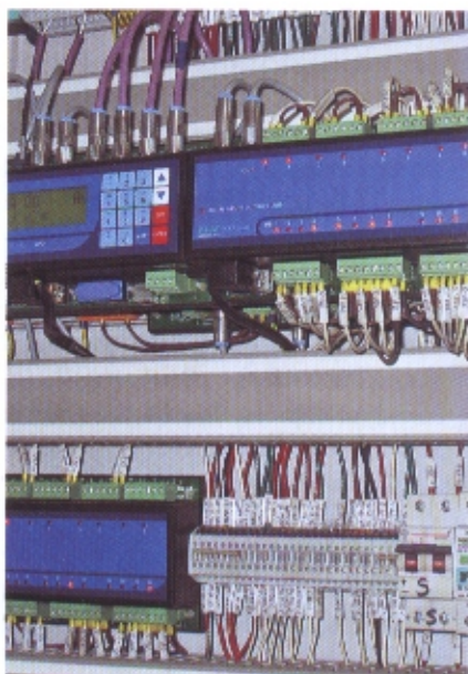
Nowoczesna automatyka w rozdzielni prądu stałego z widocznym sterownikiem CZAT 3000plus
